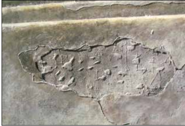
Figura 48. Restos de revocos y revestimientos murales, diferenciando los originales mediante ligeros rehundidos, que marcan el contorno de los guarnecidos que se salvaron de la destrucción, conservando los grabados y cruces esgrafiadas en los estucos que realizaron los peregrinos que visitaban el santuario.
