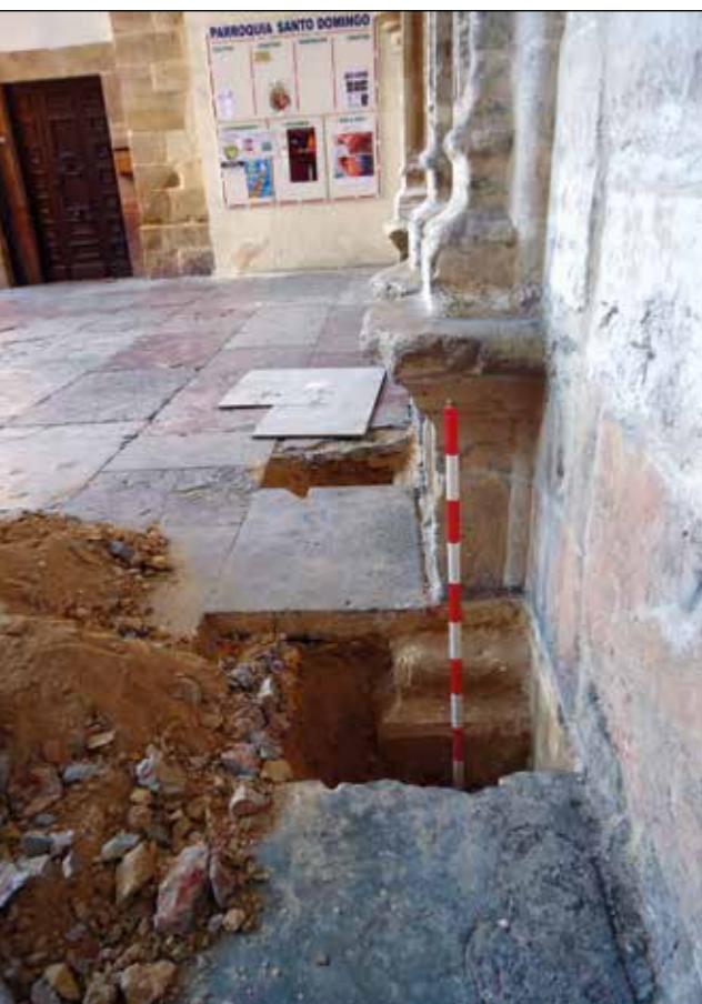
Figura 5. Imagen de las excavaciones de 2016 que muestran el alzado completo de la portada plateresca.
