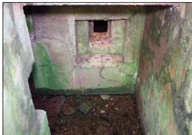
Figura 33. Vista del acceso principal al nivel inferior de uno de los FI 243, donde se observa además de la tronera que protegía dicho acceso, el nivel de colmatación de la entrada por tierra y otros escombros, así como el nivel del agua que cubre toda la construcción.
