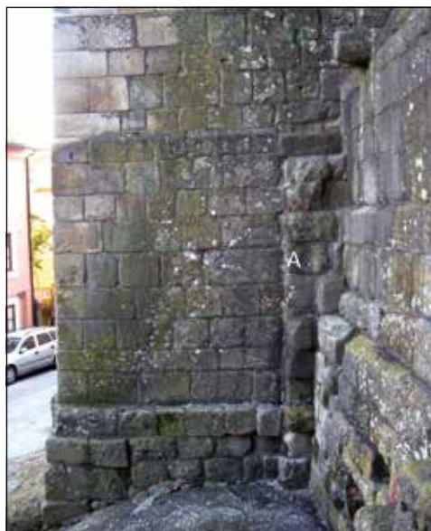
Figura 26. Sé de Viseu. Pormenor da fachada posterior, com elementos anteriores à construção gótica da catedral.
