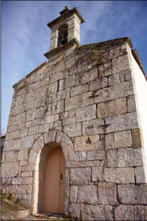
Figura 1. Fachada de la capilla de Nosa Señora do Rosario de Loio. Fotografía de María Jesús de la Torre.
