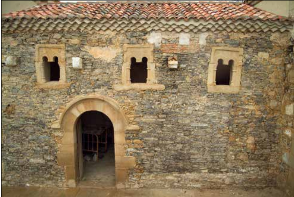
Figura 9. El muro sur de la iglesia en una imagen correspondiente a la fase de restauración. Una vez desmontado el pórtico y con el paramento visto se aprecian las roturas producidas por la portada románica y el ábside barroco.
