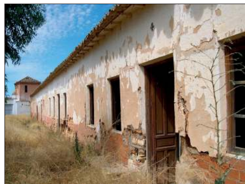
Fig. 19. Viviendas de los trabajadores de la Fábrica de Cerámica de Ciudad Real; demolidas.
