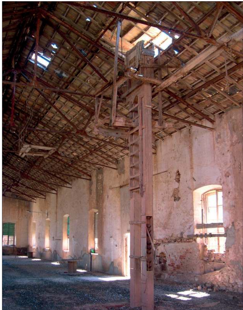
Fig. 4. Nave de amasado, cubierta mediante estructura de cerchas metálicas y teja plana, que no procede de esta fábrica. En primer plano se aprecia la cinta transportadora que, mediante canchales de madera, trasladaba los ladrillos frescos hacia el secadero anexo. Esta construcción fue demolida por completo, de forma innecesaria.
