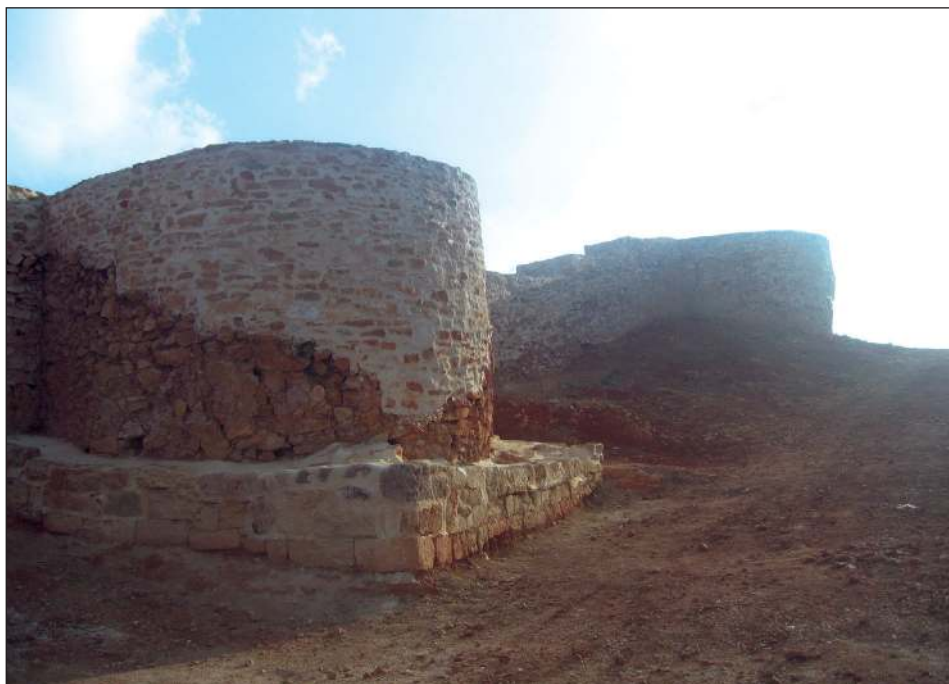
Figura 7. El castillo de Tedeja (Trespaderne, Burgos). Vista de uno de dos cubos después de la intervención (siglo V-VI).
