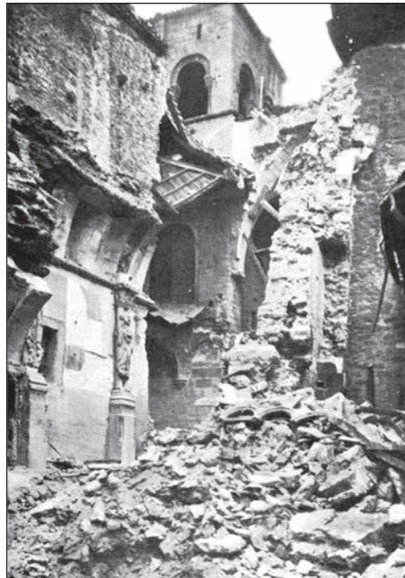
Figura 10. Cámara Santa arruinada vista desde su cabecera. Imagen extraída del Boletín de la Academia de la Historia.
