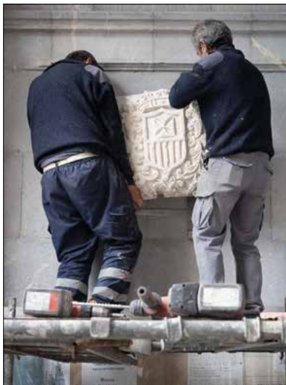
Figura 6. Colocación del antiguo escudo del convento de La Merced durante las obras de restauración de la iglesia de Santo Tomás de Sabugo. Fotografía: Omar Antuña. La Voz de Avilés. 16/05/2020
