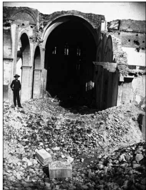
Figura 4. Demolición de las naves de la iglesia conventual de San Francisco, fondo Adolfo Armán, Archivo del Ayuntamiento de Oviedo ( http://www.oviedo.es/archivo/adolfo-arman )
