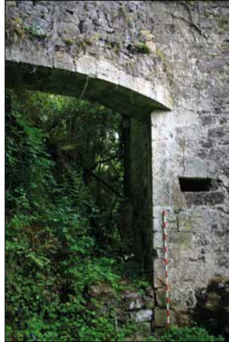
Figura 9. Tirante que sujetaba probablemente la esquina de la iglesia trasladando los empujes a la roca.
