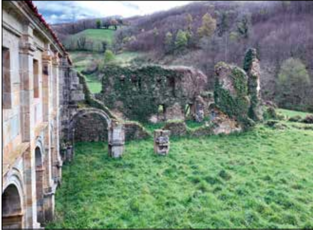
Figura 14. Vista de los vestigios conservados de la panda oriental, con los restos de la torre en la esquina sudeste del recinto claustral.
