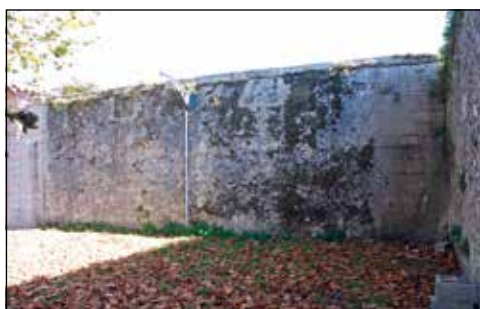
Figura 16. Vestigios de la edificación localizada al sudoeste del patio de servicio. Se aprecian dos ventanas arrasadas correspondientes a un piso alto. Fotografía de los autores.
