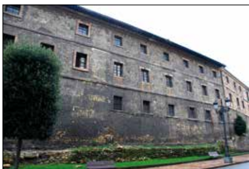
Figura 9. Crujía norte de la renovación barroca. 1694-1700. Fotografía: César García de Castro Valdés.
