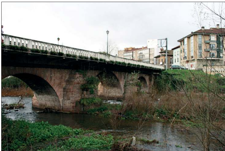
Figura 3. Puente sobre el río Cubia en San Pelayo, obra de Manuel Reguera.
