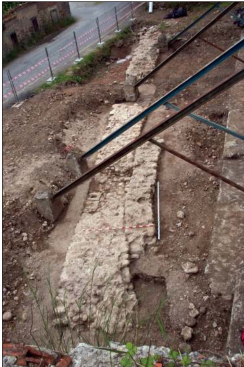
Figura 10. Vista general del trazado excavado de la cimentación de la muralla tomada desde el norte durante el proceso de excavación en el año 2012 (imagen cortesía de Sergio Ríos).
