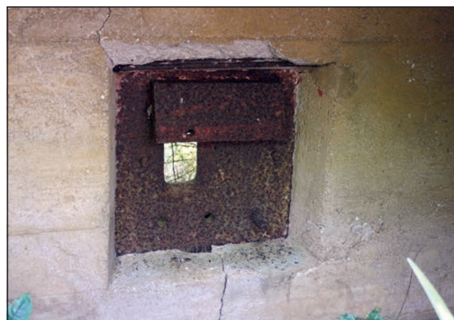
Figura 34b: Detalle interior de una de las troneras defensivas de estas estructuras.
