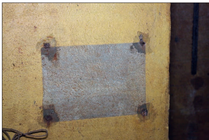
Figura 35. Marcas en la pared de algún tipo de cartel para indicaciones u órdenes para sus ocupantes (fotografías autor).
