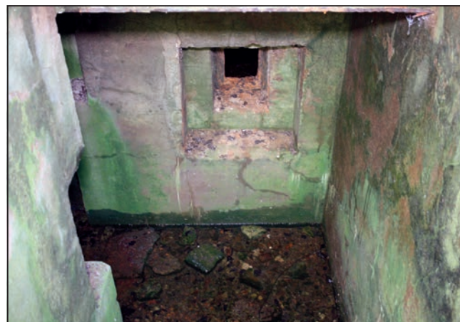
Figura 33. Vista del acceso principal al nivel inferior de uno de los FI 243, donde se observa además de la tronera que protegía dicho acceso, el nivel de colmatación de la entrada por tierra y otros escombros, así como el nivel del agua que cubre toda la construcción.
