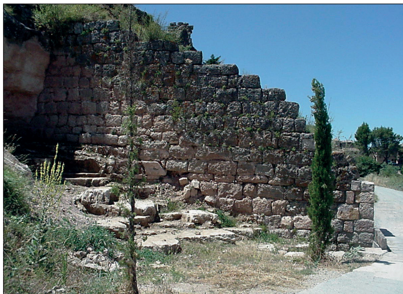
Figura 13. Coracha de grandes bloques de sillaría del castillo de Siurana, Cornudella de Montsant.
