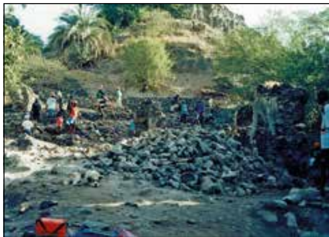
Figura 8. Trabajos de limpieza y acondicionamiento en el lado norte del convento de San Francisco.
